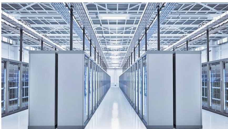
Figur 4-10. Datahall. Bild: Racktech
