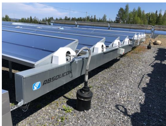
Figur 4-13. Solfångarpark på 1 MW i Härnösand kopplade till HEMAB:s fjärrvärmenät.
