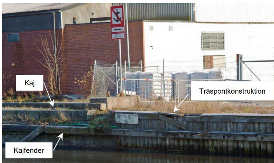
Figur 16. Träspontkonstruktionens anslutning vid Kaj B och C (Foto: PM Deformationer i träspontkonstruktion, Bjerking AB, daterad 2012-03-07).
