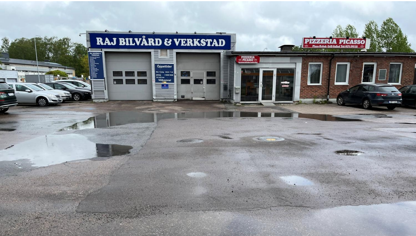
Cisternpaket samt oljeavskiljare utanför verkstad.
