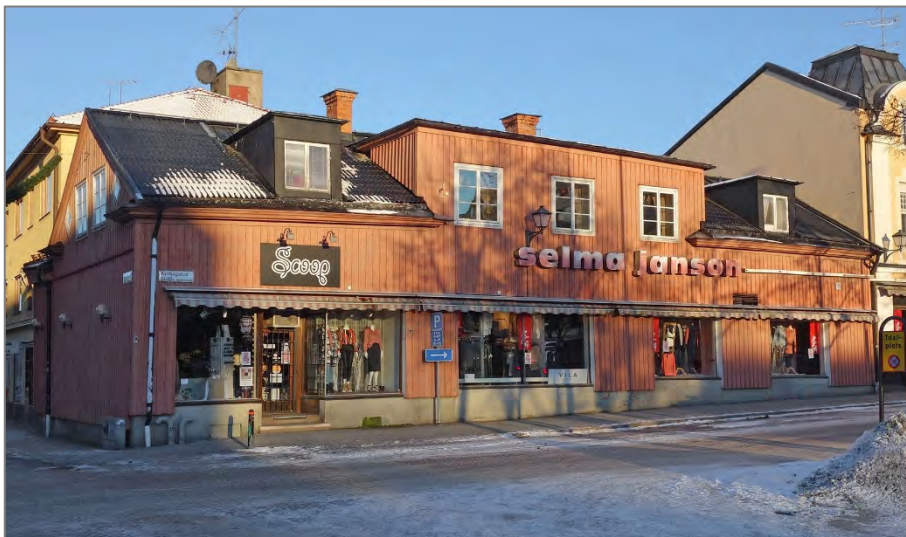
”Selma Janson” i hörnet Kyrkogatan/Källgatan, i kvarteret Buntmakaren, är ett talande exempel på de ovarsamma förändringar som gjorts på många av de äldre husen. Detta hus hade tidigare en putsad fasad och tegeltak (jämför med bilden på sidan 9).
