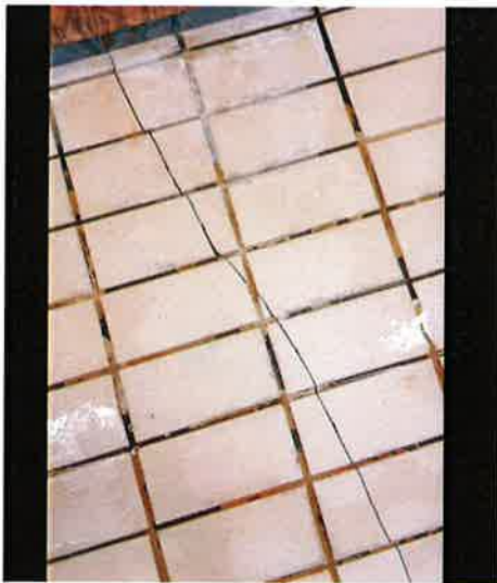
Spricka i golvet av okänd orsak
