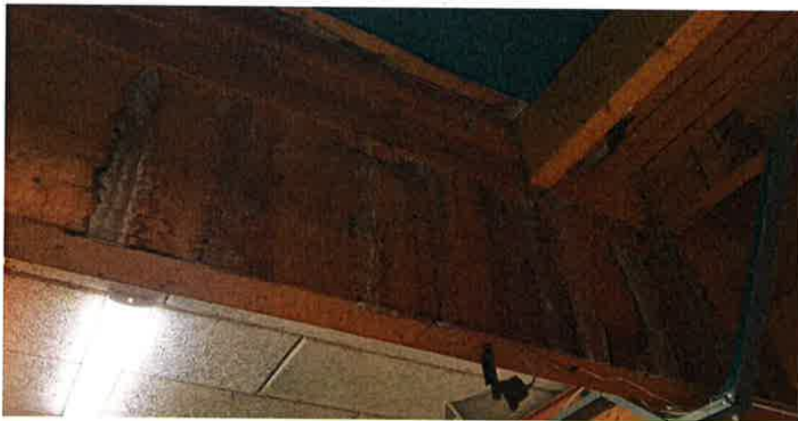
Vatten från taket/väggen har runnit längs limträbalken
